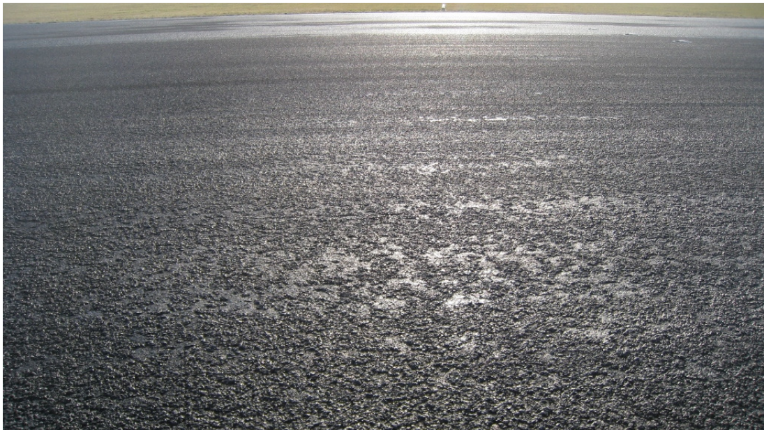
Bild 7: Beginnender Kornverlust im Anti-Skid-Belag in der Aufsetzzone – keine Rissbildung im gesamten Bereich
