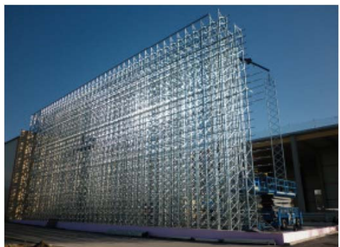
Bild 7. Regalsystem des Hochregallagers, Höhe ca. 20m
