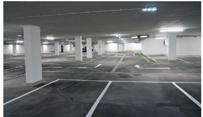
Bild 2 Tiefgarage, ausgeführt als Stahlfaserbeton-Kombinationsbewehrung und Beschichtungssystem Underground car park made out of hybrid reinforcement with an applied coating system
